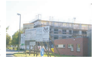
Der Rohbau wurde bereits errichtet. Im März 2014 soll das Haus bezugsfertig sein
